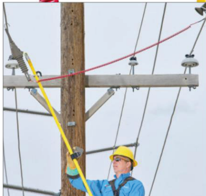
Rádio Voltstik, condutor aéreo
